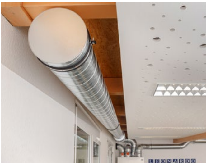
Abluftrohr, Deckeninstallation im Klassenraum
