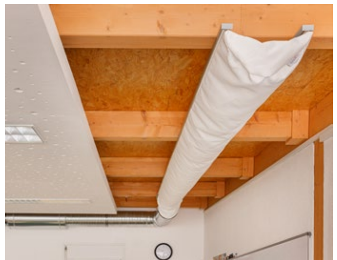
Zuluft strömt über einen Luftschlauch in den Raum
